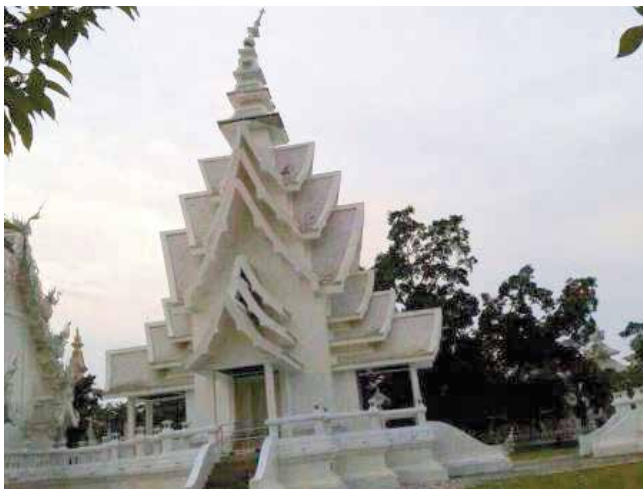
ยอดฉัตร วัดร่องขุน เอียงจากเหตุการณ์แผ่นดินไหว
