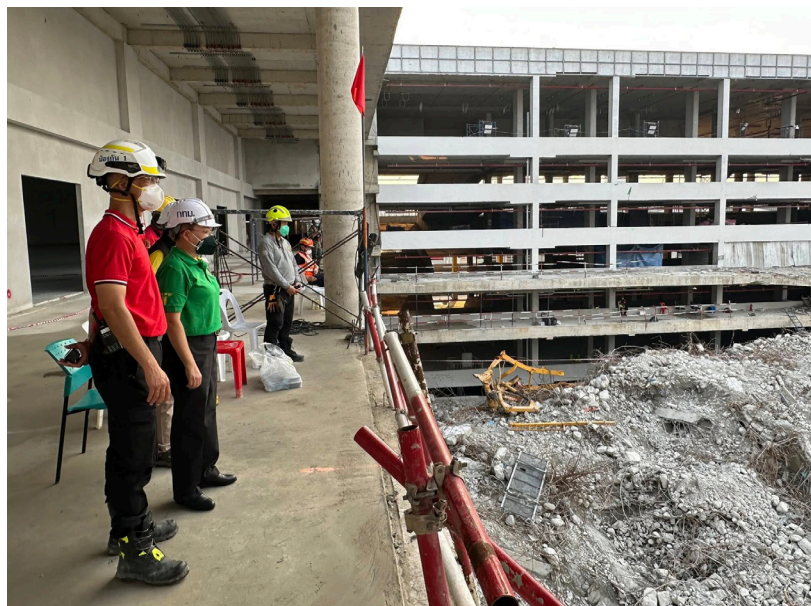
ภารกิจค้นหาผู้สูญหายจากอาคาร สดง.ถล่มจากเหตุแผ่นดินไหว
